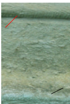
Abb. 6.1: Ablaufspuren, unregelmäßige Zurückwitterung und grüne Verfärbung, Nordfassade, Alte Pinakothek
