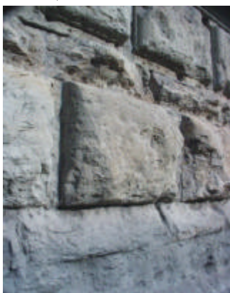
Abb. 6.2: Zustand der Sandsteinelemente an der Westfassade, Alte Pinakothek
