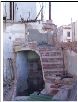
Foto 37, 38 und 39: Vor allem in den Stadtbezirken Centro Habana bzw. Habana Vieja wird der Verfall der Bausubstanz besonders deutlich (Ammerl 12/2003)
