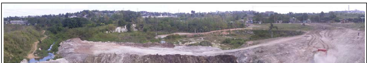
Foto 200: Panoramaaufnahme des Sektors Callejón de Andrade nach Norden und Osten. Zu Beginn des Jahres 2004 begann das Staatsunternehmen Contingente Blas Roca mit dem Abbau von Kalkmergel, der anschließenden Säuberung der Müllhalde sowie der Anlage von Staubecken und Wegen (Foto: Ammerl 02/2003)
