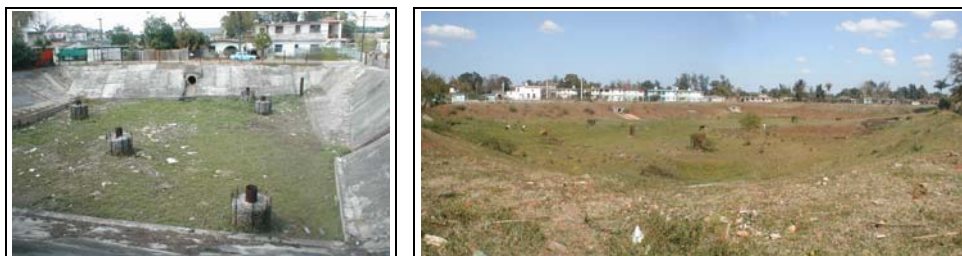
Foto 35 und 36: Drainagebecken im Stadtbezirk Boyeros für den Schutz des nahen Flughafens José Martí Internacional vor Überschwemmung (Ammerl 01/2003)
